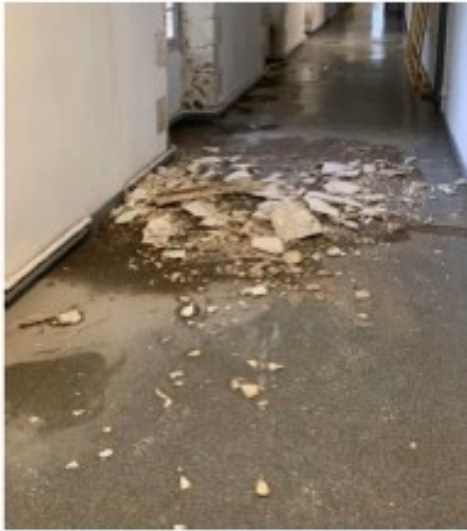
Dégâts à la suite d'un orage à l'ENSA de Bourges.
